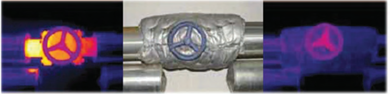
Şekil 13: Yalıtımlı ve Yalıtımsız Vana Isı Kayıpları
