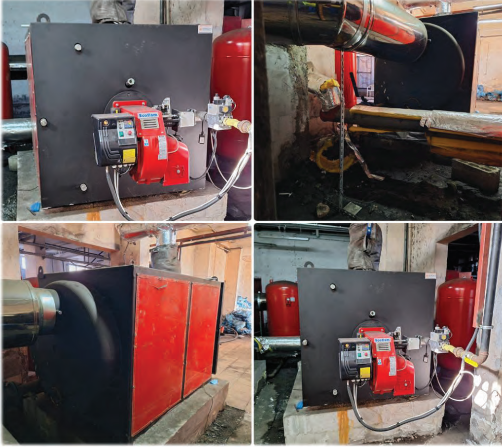
Şekil 8: Isı Merkezi – Yer Tipi Sıcak Su Kazanı
